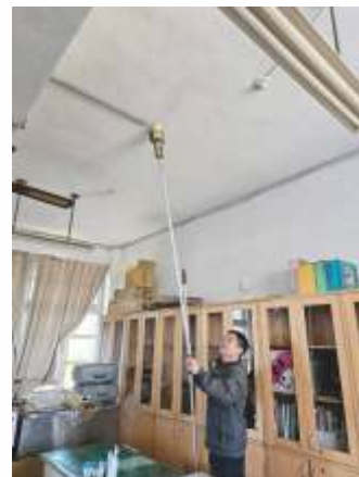
消防設備年度檢修
